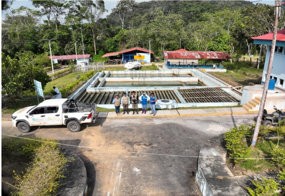
Foto N°31: Área de captación superficial utilizada para el abastecimiento del sistema de agua potable de la EPS.
