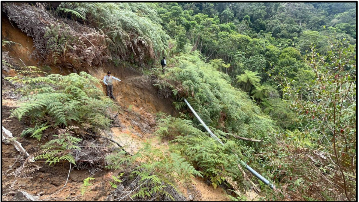
Foto N°2: Tramo de la tubería de conducción de la captación Chuyayacu afectado por deslizamiento que eliminó su apoyo natural. (290140.310E, 9333789.950N)
