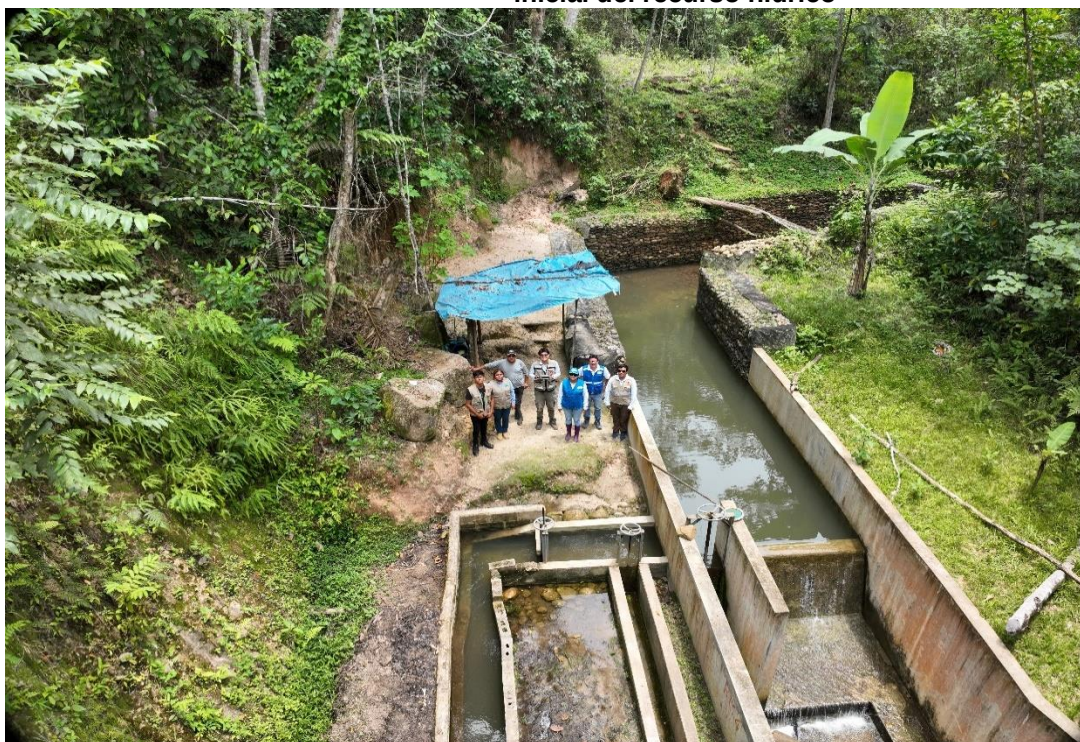
Foto N°25: Infraestructura hidráulica utilizada para la captación y conducción inicial del recurso hídrico
