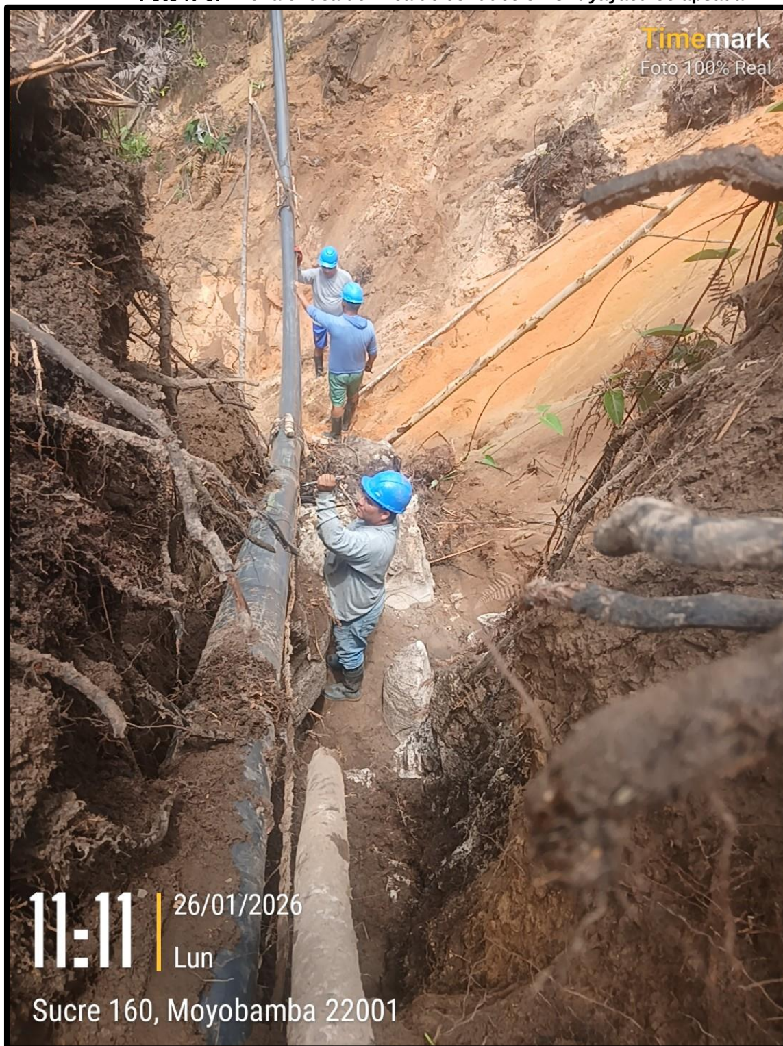
Foto N°3: Zona crítica de línea de conducción Chuyayacu colapsada
