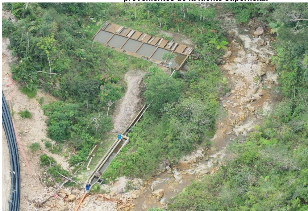
Foto N°15: Instalaciones de pretratamiento y conducción de agua cruda provenientes de la fuente superficial.
