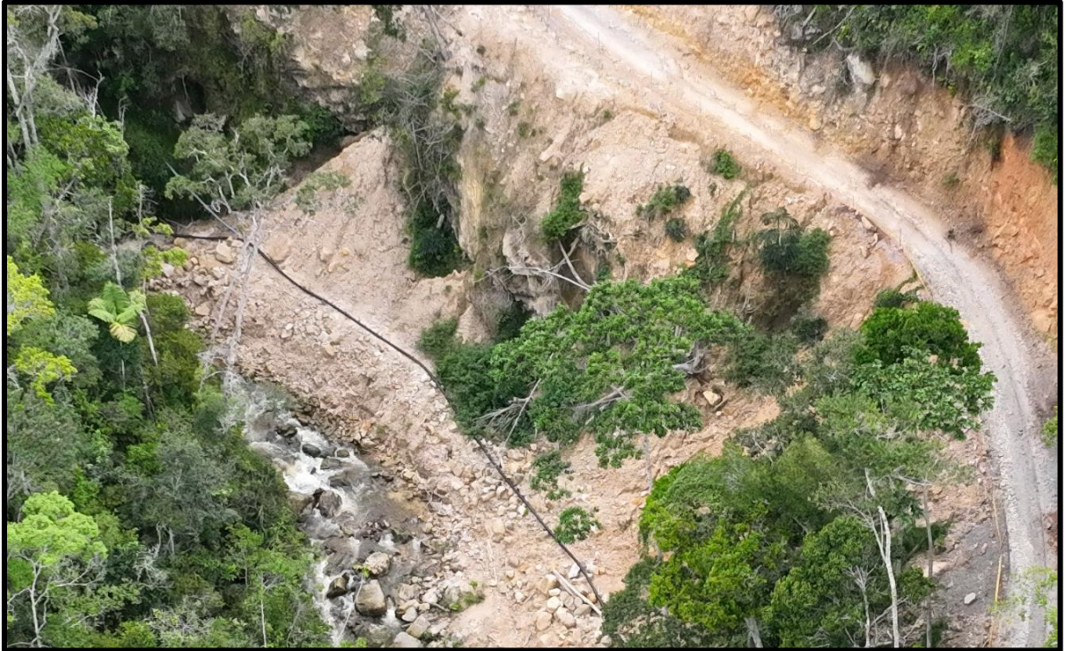
Foto N°1: Sector con fallas repetitivas en la conducción por deslizamientos – Sistema Juninguillo. (290395.861E, 9334215.492N)
